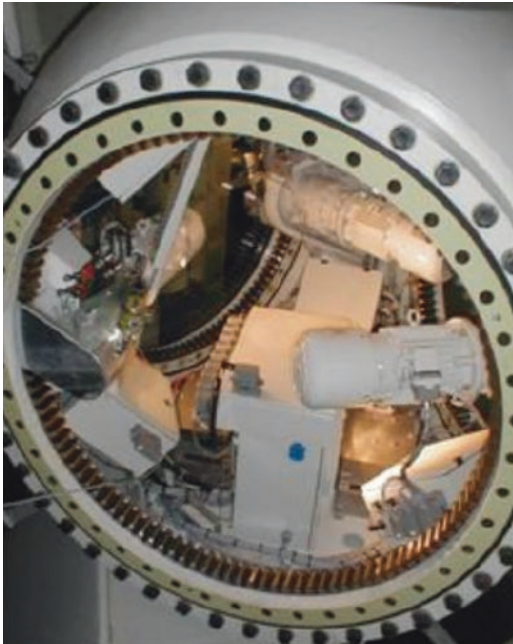
■ Abb. 6.32 Superkondensator zur Versorgung der Rotorblattverstellung in der Nabenmitte einer Windkraftanlage [16]
