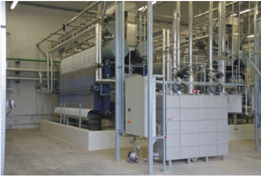
▣ Abb. 14.16 Zwei der drei alkalischen Elektrolyseure von McPhy Energy Deutschland GmbH aus Berlin mit je 2 MW elektrischer Anschlussleistung zur Herstellung von Wasserstoff für die Methanisierung in der Audi e-gas-Anlage in Werlte, Niedersachsen
