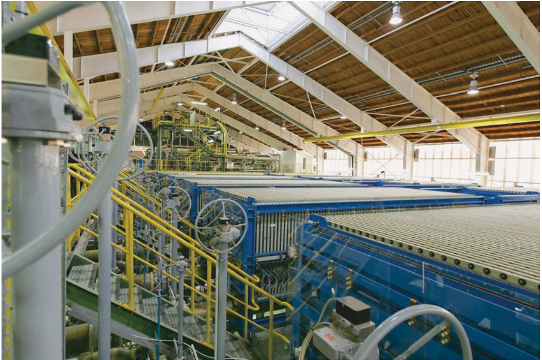
■ Abb. 8.5 Anlage zur Chlor-Alkali-Elektrolyse der Vestolit GmbH in Marl, Deutschland mit einer jährlichen Produktionskapazität von 237.000 t Natriumhydroxid und 210.000 t Chlor, welche von der ThyssenKrupp Electrolysis GmbH (früher Electrolysis Division der ThyssenKrupp Uhde GmbH), Dortmund projektiert wurde (Quelle: ThyssenKrupp Electrolysis GmbH)
