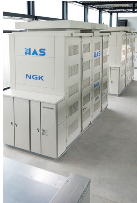
Abb. 7.61 Ein 1 MW NaS-Speicherblock der Younicos AG in Berlin
