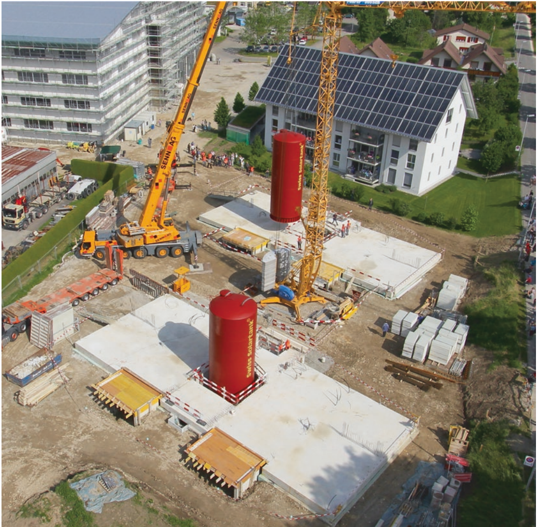
■ Abb. 13.41 Speicher des zu 100 % solar beheizten Mehrfamilienhauses in Bern, Schweiz (Quelle: Jenni Energietechnik AG)
