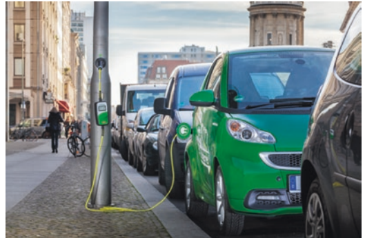
■ Abb. 14.13 Elektrofahrzeug lädt mit mobilem Stromzähler im Ladekabel an Lichtmast mit integrierter Systemsteckdose (Quelle: ubitricity GmbH, Robert Lehmann)
