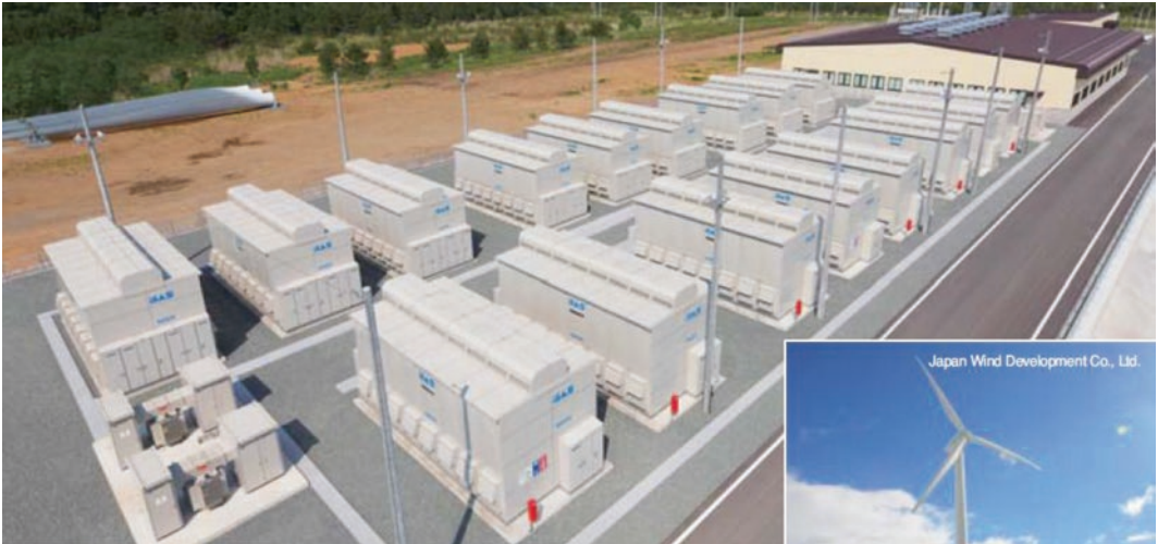
■ Abb. 7.63 34 MW NaS-Speicherblocksystem
