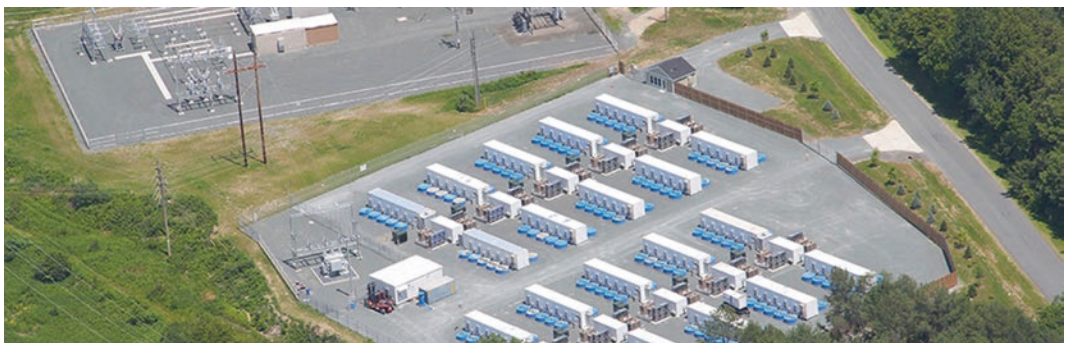
■ Abb. 13.16 20 MW-Schwungradspeicher für Frequenzstabilisierung im Bundesstaat New York (Quelle: Beacon Power LLC)
