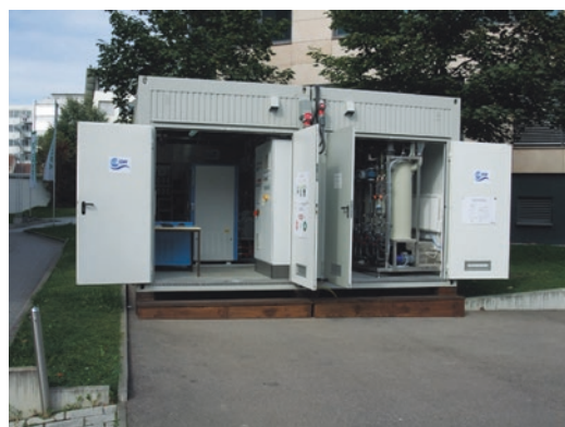
■ Abb. 14.28 Power-to-Gas-Forschungsanlage im 250 kW-Maßstab am ZSW in Stuttgart: Beta-Anlage (Quelle: ZSW Stuttgart)
