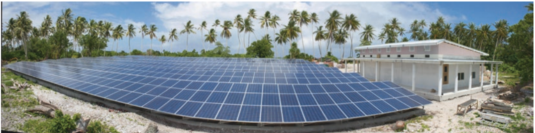
■ Abb. 13.33 Die neue Stromversorgung auf Tokelau
