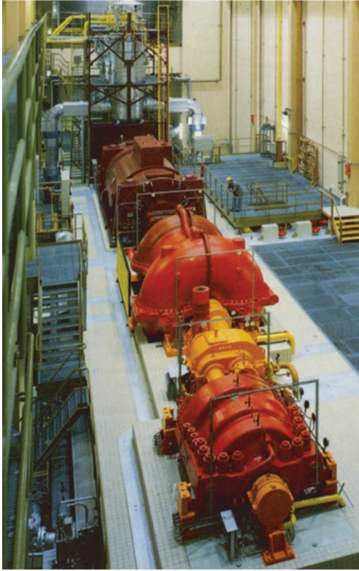
■ Abb. 9.3 Innenansicht des Druckluftspeicherkraftwerkes in Huntorf (Quelle: E.ON Kraftwerke GmbH)
