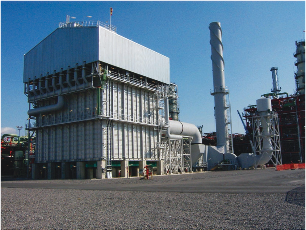
■ Abb. 8.6 Anlage zur Dampfreformierung der Neste Oil Oyj in Porvoo, Finnland mit einer jährlichen Produktionskapazität von 153.000 Nm 3 /h Wasserstoff, welche von der ThyssenKrupp Industrial Solutions AG (früher Uhde GmbH), Dortmund projektiert wurde (Quelle: ThyssenKrupp Industrial Solutions AG)
