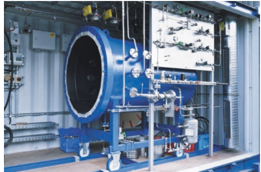
Abb. 14.21 Hochtemperaturelektrolyse der sunfire-Power-to-Liquids-Anlage in Dresden (Quelle: sunfire GmbH)
