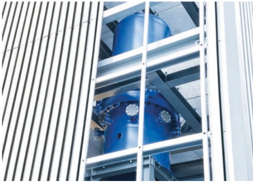
■ Abb. 14.22 Hochtemperaturelektrolyse der sunfire-Power-to-Liquids-Anlage in Dresden zur Produktion von Stromkraftstoffen durch die Fischer-Tropsch-Synthese über Power-to-Liquid (Bildquelle: sunfire GmbH)
