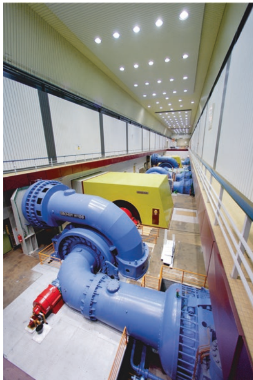
■ Abb. 13.12 Maschinenhalle des Pumpspeicherwerks Wehr (Quelle: Schluchseewerk AG)
