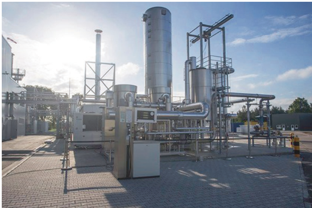
■ Abb. 14.18 Aminwäsche zur Biogasaufbereitung der Abfallbiogasanlage in Werlte. In dieser Anlage wird das Kohlendioxid vom Biogas abgetrennt, um es als Biomethan in das Gasnetz einzuspeisen. Das abgetrennte \text{CO}_2 wird anschließend in der Methanisierungsanlage der Audi e-gas-Anlage verwendet (Quelle: Audi AG)
