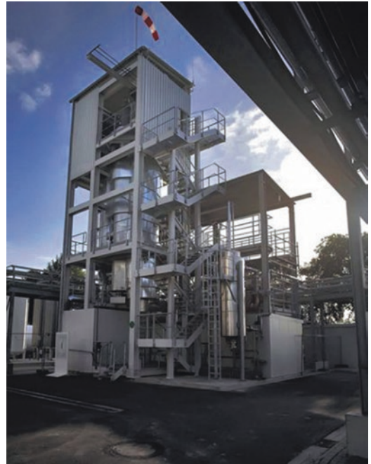
▣ Abb. 14.17 Chemische Methanisierungsanlage der MAN Diesel & Turbo SE aus Deggendorf zur Umsetzung des Sabatier-Prozesses für die Gewinnung von Stromkraftstoff in der Audi e-gas-Anlage in Werlte (Quelle: Audi AG)
