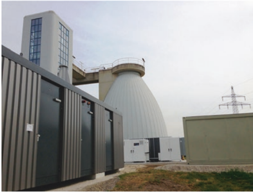
■ Abb. 14.30 Rührtankreaktor mit einem Fassungsvermögen von 10.000 l für die biologische Methanisierung in Dänemark, realisiert und betrieben von Electrochaea.dk (Quelle: Electrochaea.dk)
