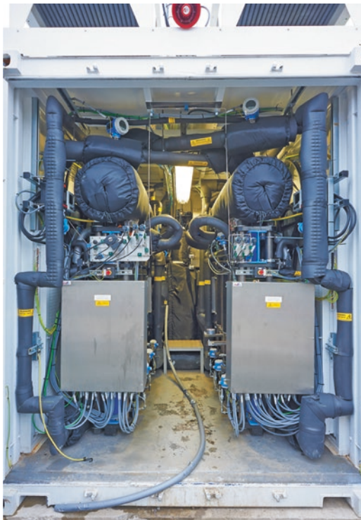
■ Abb. 14.27 Power-to-Gas-Pilotanlage im 25 kW-Maßstab am ZSW in Stuttgart: Alpha-Anlage (Quelle: ZSW Stuttgart)
