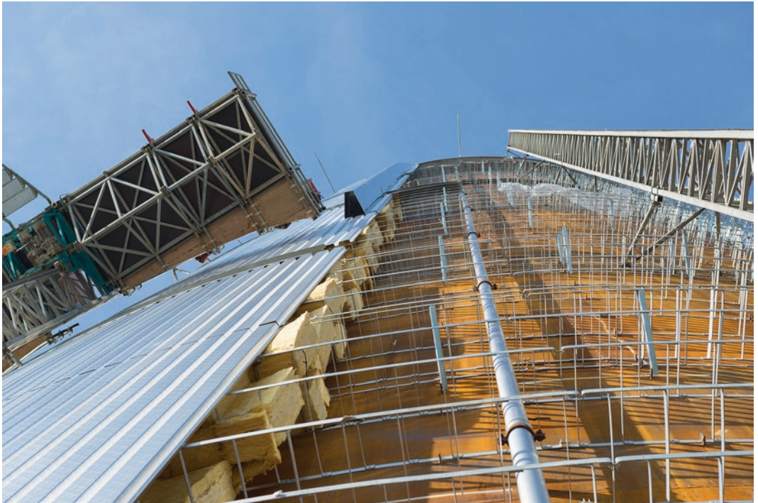
■ Abb. 14.5 Fassade und 50 cm dicke Wärmedämmung des Wärmespeichers Sandreuth zur Flexibilisierung der KWK und zum Einsatz von Power-to-Heat (Quelle: N-Ergie Kraftwerke GmbH)
