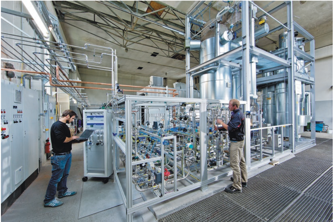
■ Abb. 14.29 Power-to-Biogas-Anlage der MicroEnergy GmbH (Viessmann-Gruppe) mit PEM-Elektrolyseur (Mitte), Mischanlage (vorne links) und Faulturm (hinten links) in der Nähe eines alten Kraftwerksstandorts (Quelle: MicroEnergy GmbH)
