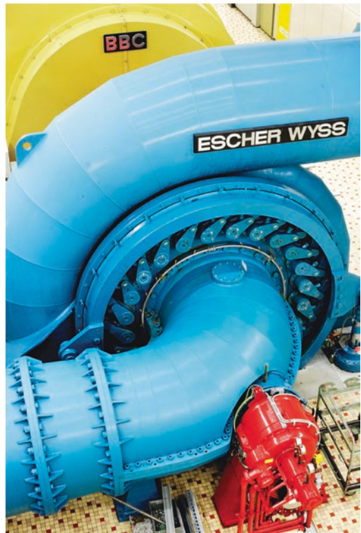
■ Abb. 13.10 Turbinenhalle des Kavernenkraftwerks Säckingen (Quelle: Schluchseewerk AG)
