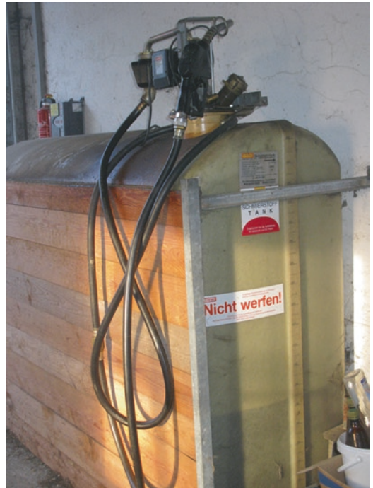
► Abb. 8.58 Dieseltankstelle in einem land- und forstwirtschaftlichen Betrieb
