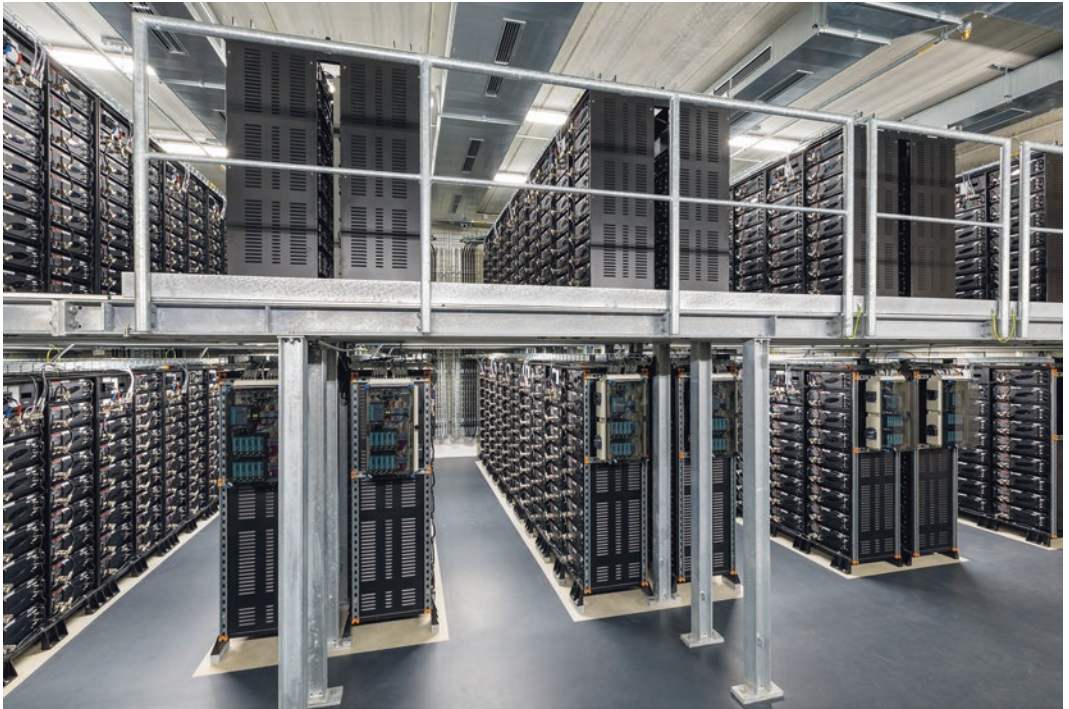
■ Abb. 13.18 Innenansicht des Batteriekräftwerkes der WEMAG/Younicos AG auf Basis von Lithium-Ionen-Akkus in Schwerin, Mecklenburg-Vorpommern (Quelle: Younicos AG)
