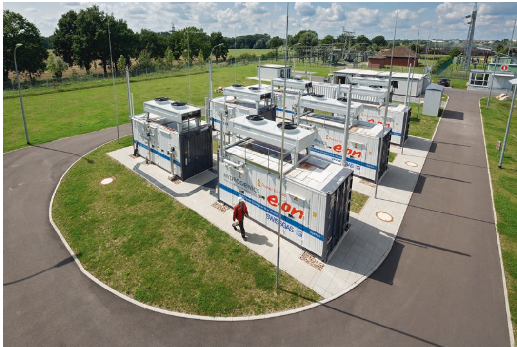
■ Abb. 14.26 Die Strom-zu-Gas-Demonstrationsanlage der Thüga AG in Frankfurt mit einer Nennleistung von 315 kW (Quelle: Thüga AG)
