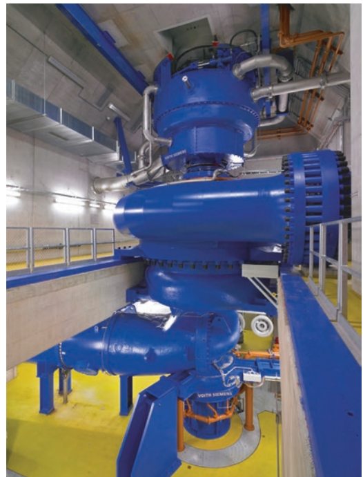
■ Abb. 13.6 Pumpensatz des Kopswerks II der Vorarlberger Illwerke AG, der mit dem Generator (oben durch die Decke) zur Umsetzung des hydraulischen Kurzschlusses gekoppelt ist (Quelle: Vorarlberger Illwerke AG)
