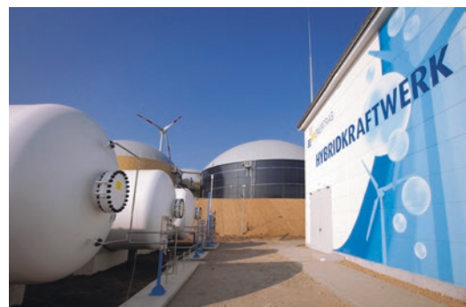
■ Abb. 14.25 Power-to-Gas-Pilotanlage der E.ON SE in Falkenhagen zwischen Berlin und Hamburg mit einer elektrischen Nennleistung von 2 MW als erste Anlage zur Einspeisung von Wasserstoff in das Erdgashochdrucknetz (Quelle: E.ON SE)
